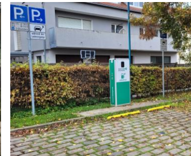
Kfz-Ladesäule mit zwei Ladepunkten der Stadtwerke Ditzingen
